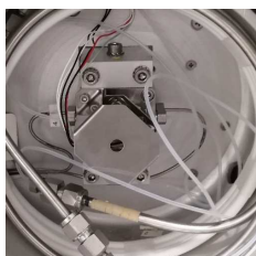
オープンに設置された TCD 外観 左右から配管が出ているのが見えます
